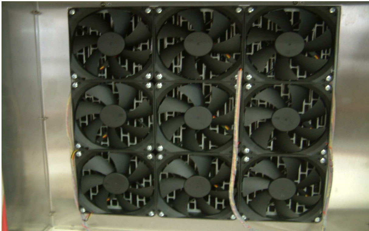
Abbildung 45: Wärmetauscher mit den 3 Lüftereinheiten
